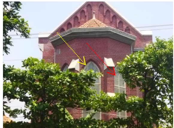
Gambar 17. Material kayu (panah kuning) dan kaca (panah merah) pada jendela
